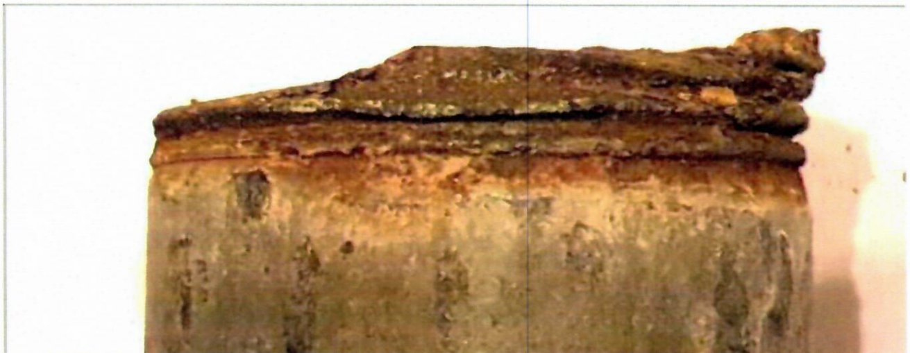
ФОТО 27 (коррозионные повреждения металла на наружной поверхности трубы в её резьбовой части)
