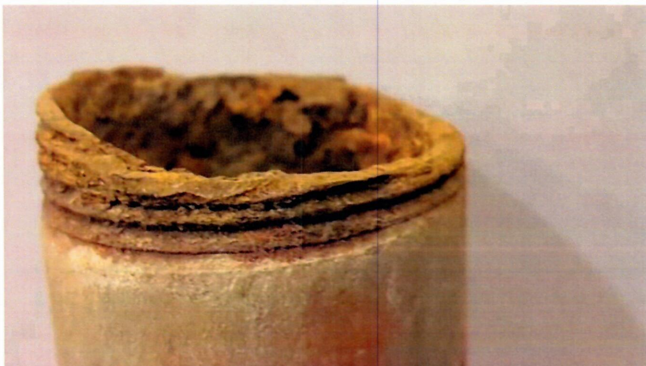
ФОТО 11 (вид торцевой поверхности трубы Ду32 в зоне разрушения; коррозия наружной поверхности резьбовой части трубы; коррозионно-наносные отложения на внутренней поверхности трубы)
