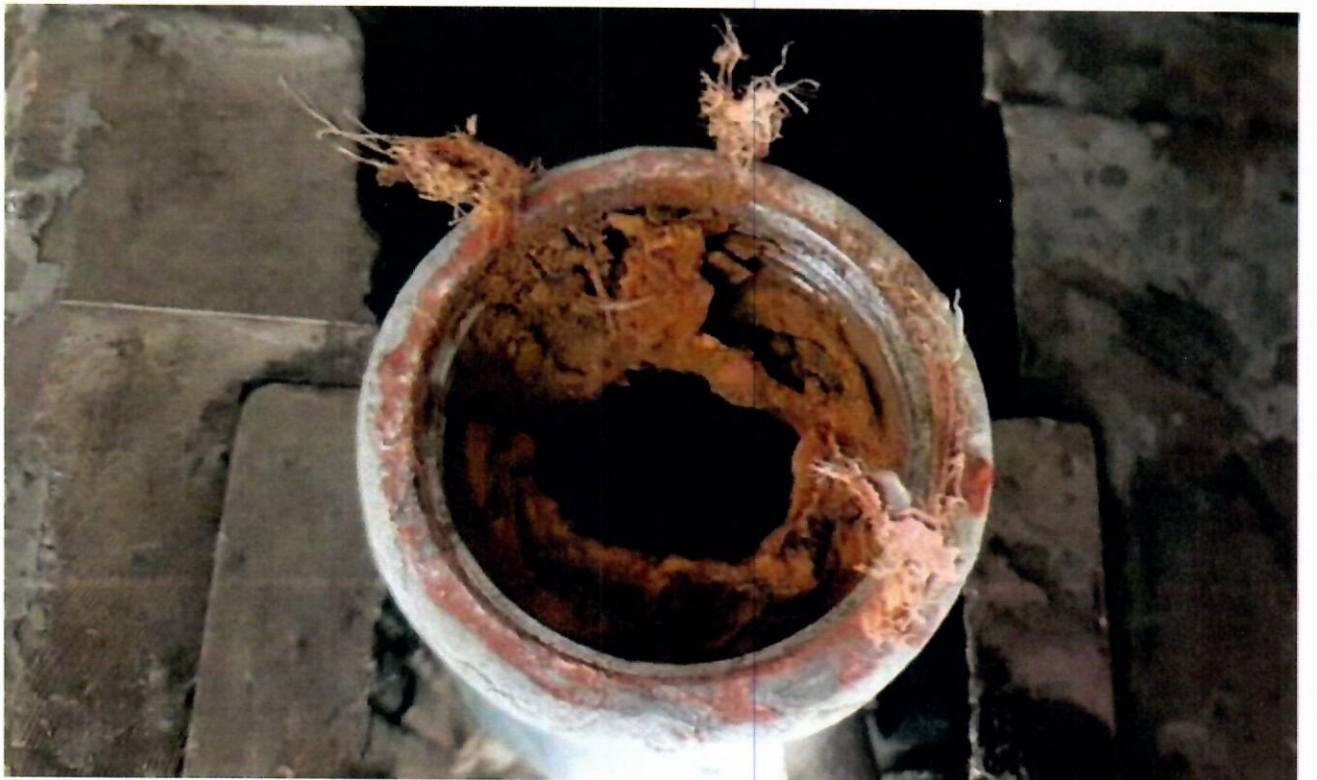
ФОТО 36 (остатки льняного уплотнителя и коррозионно-наносные отложения в резьбовой части тройника)
