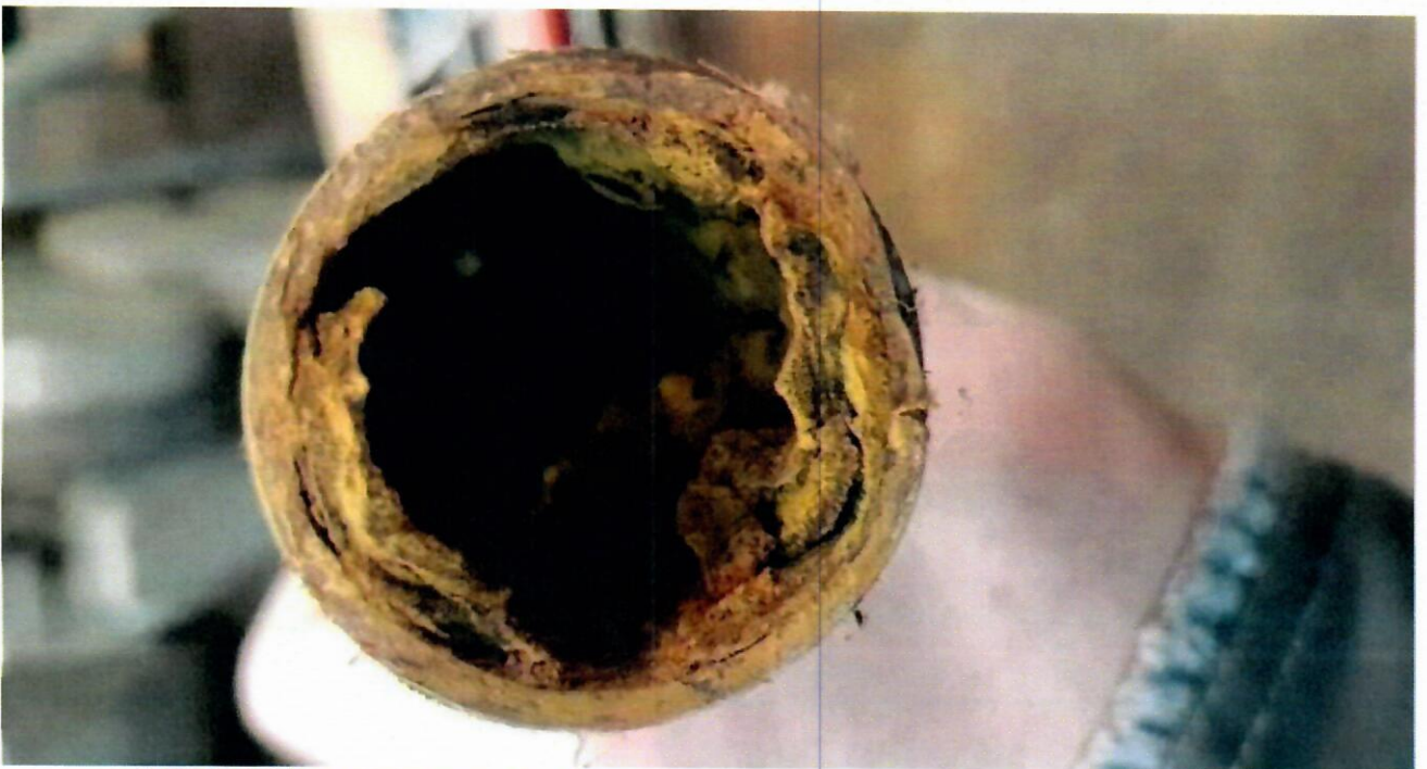
ФОТО 38 (коррозионно-наносные отложения в резьбовой части тройника)
