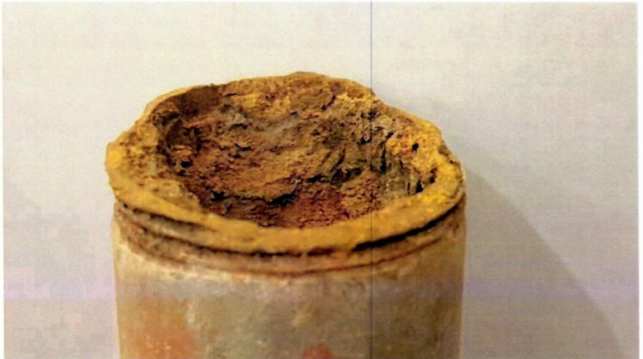
ФОТО 12 (вид торцевой поверхности трубы Ду32 в зоне разрушения; коррозия наружной поверхности резьбовой части трубы; коррозионно-наносные отложения на внутренней поверхности трубы)
