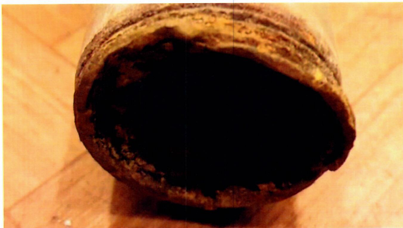
ФОТО 9 (вид торцевой поверхности Трубы Ду32 в зоне разрушения)
