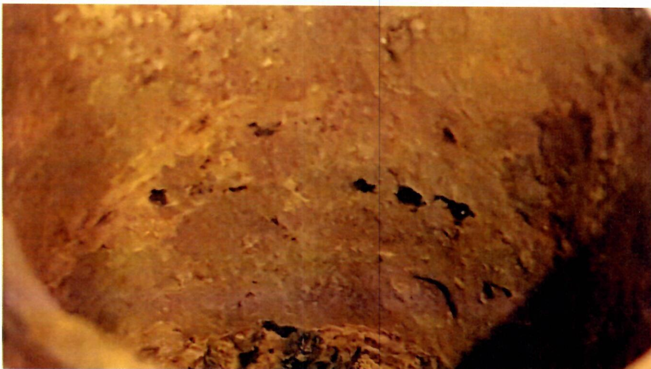
ФОТО 22 (вид внутренней поверхности трубы после удаления с неё коррозионно-наносных отложений; коррозионные повреждения металла на внутренней поверхности трубы)
