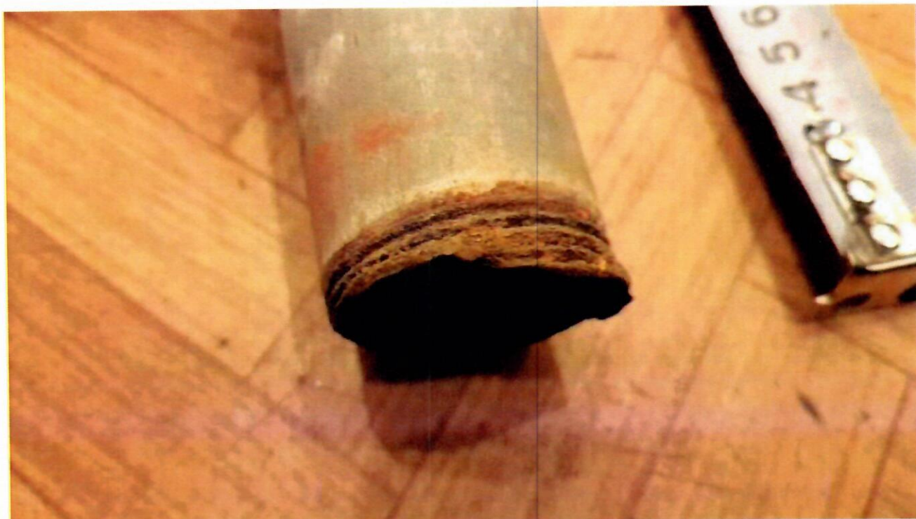
ФОТО 8 (место разрушения трубопровода)
