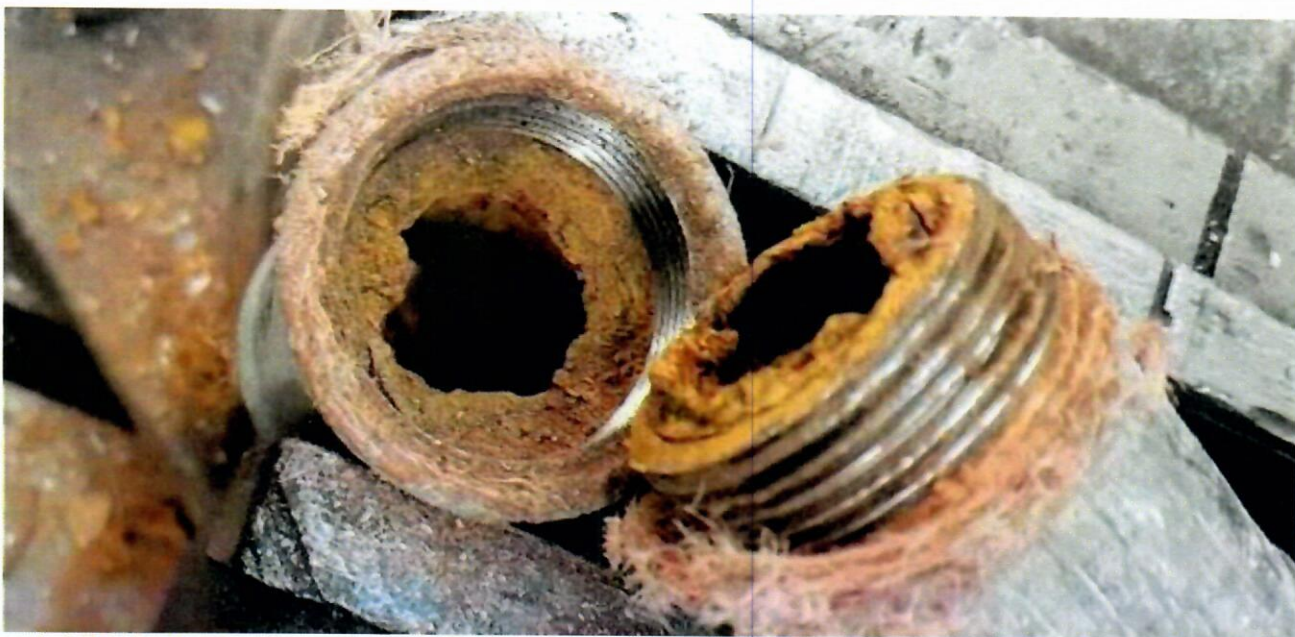
ФОТО 39 (коррозионно-наносные отложения в резьбовой части тройника и трубы; вид резьбы на трубе Ду 32 и тройнике)
