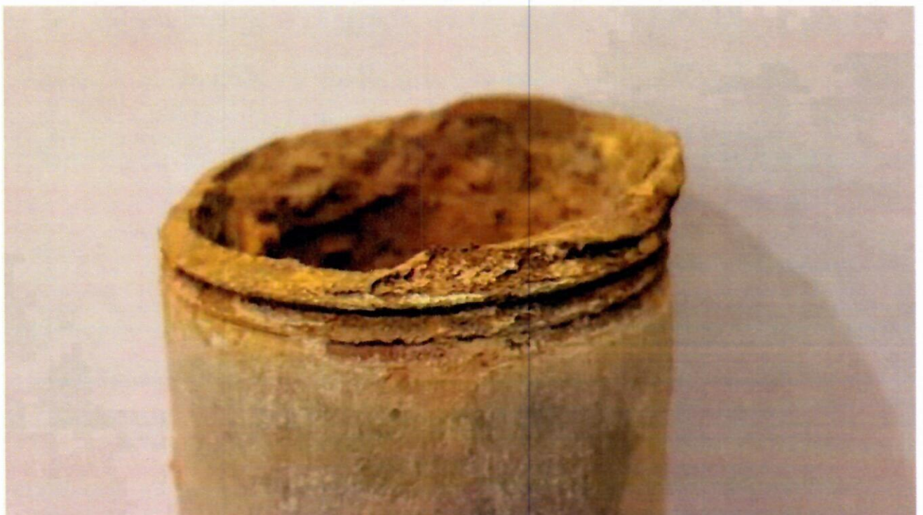
ФОТО 13 (вид торцевой поверхности трубы Ду32 в зоне разрушения; коррозия наружной поверхности резьбовой части трубы; коррозионно-наносные отложения на внутренней поверхности трубы)
