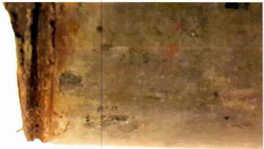
ФОТО 28 (коррозионные повреждения металла на наружной поверхности трубы в её резьбовой части)
