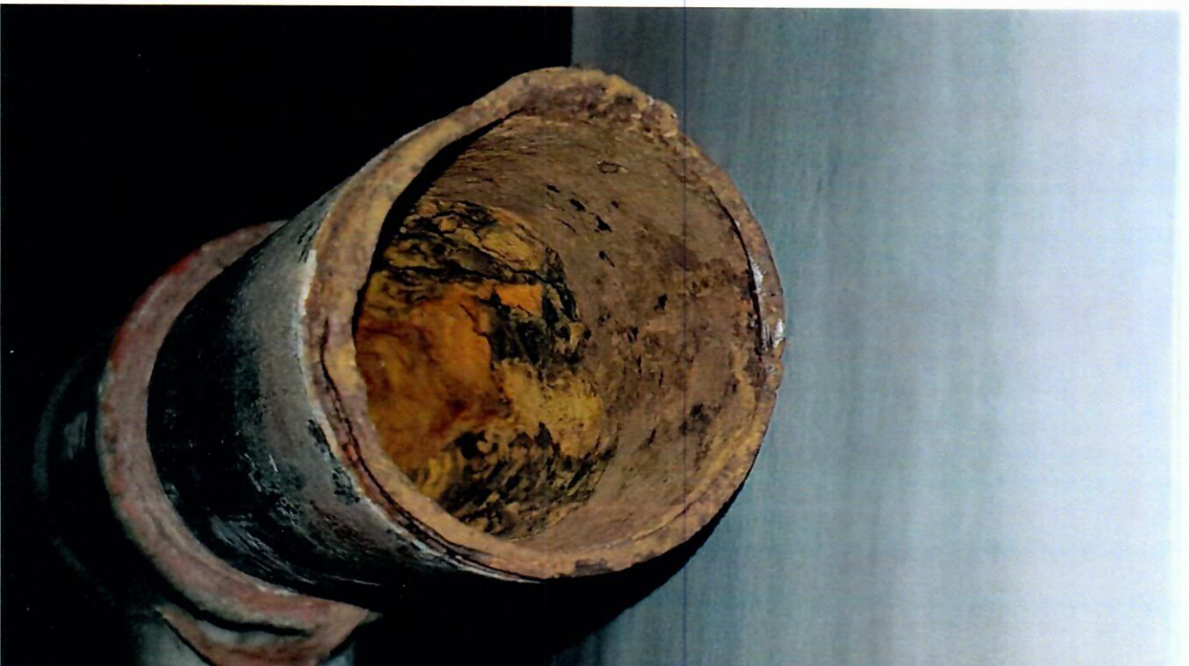
ФОТО 19 (вид внутренней поверхности трубы после удаления с неё слоя коррозионно-наносных отложений)
