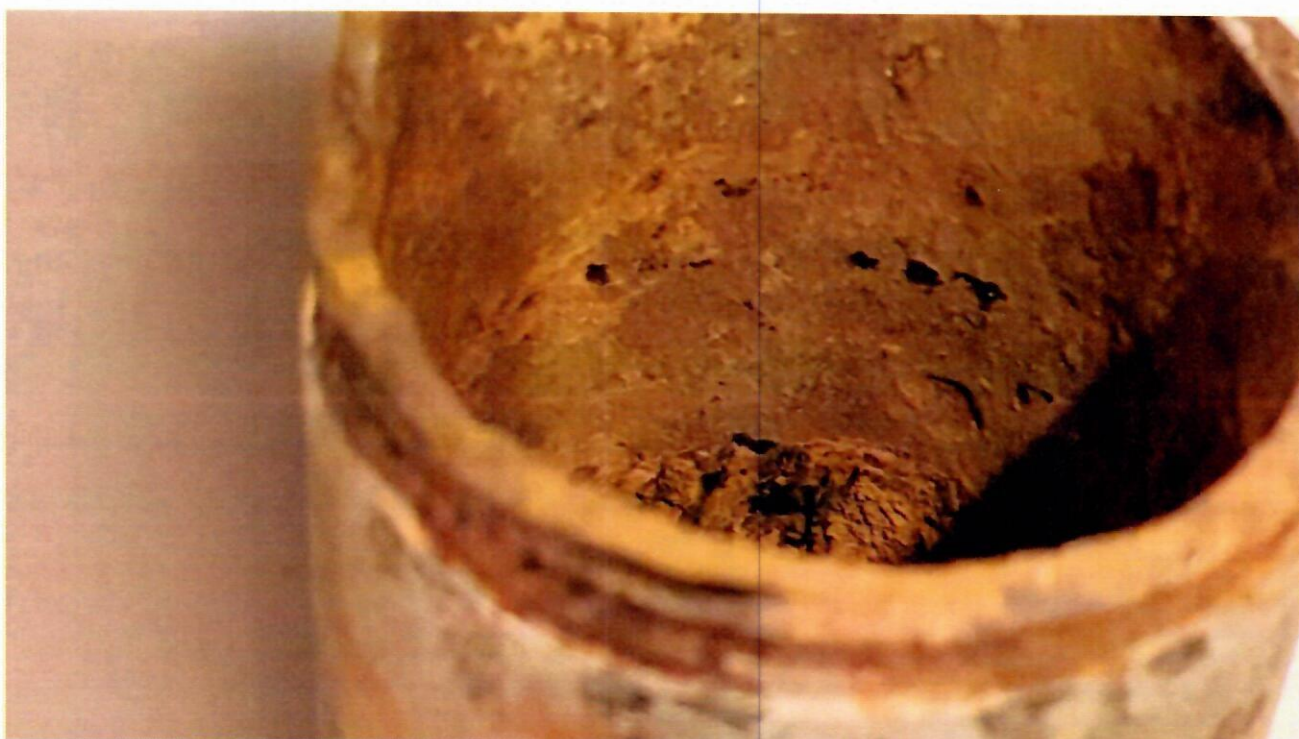
ФОТО 21 (вид внутренней поверхности трубы после удаления с неё коррозионно-наносных отложений; коррозионные повреждения металла на внутренней поверхности трубы)
