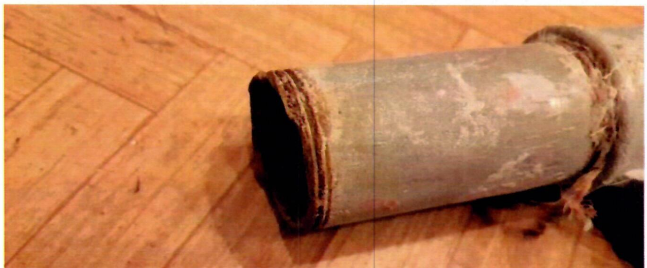
ФОТО 7 (предоставленный к исследованию участок трубопровода; месторазрушения показано стрелкой)
