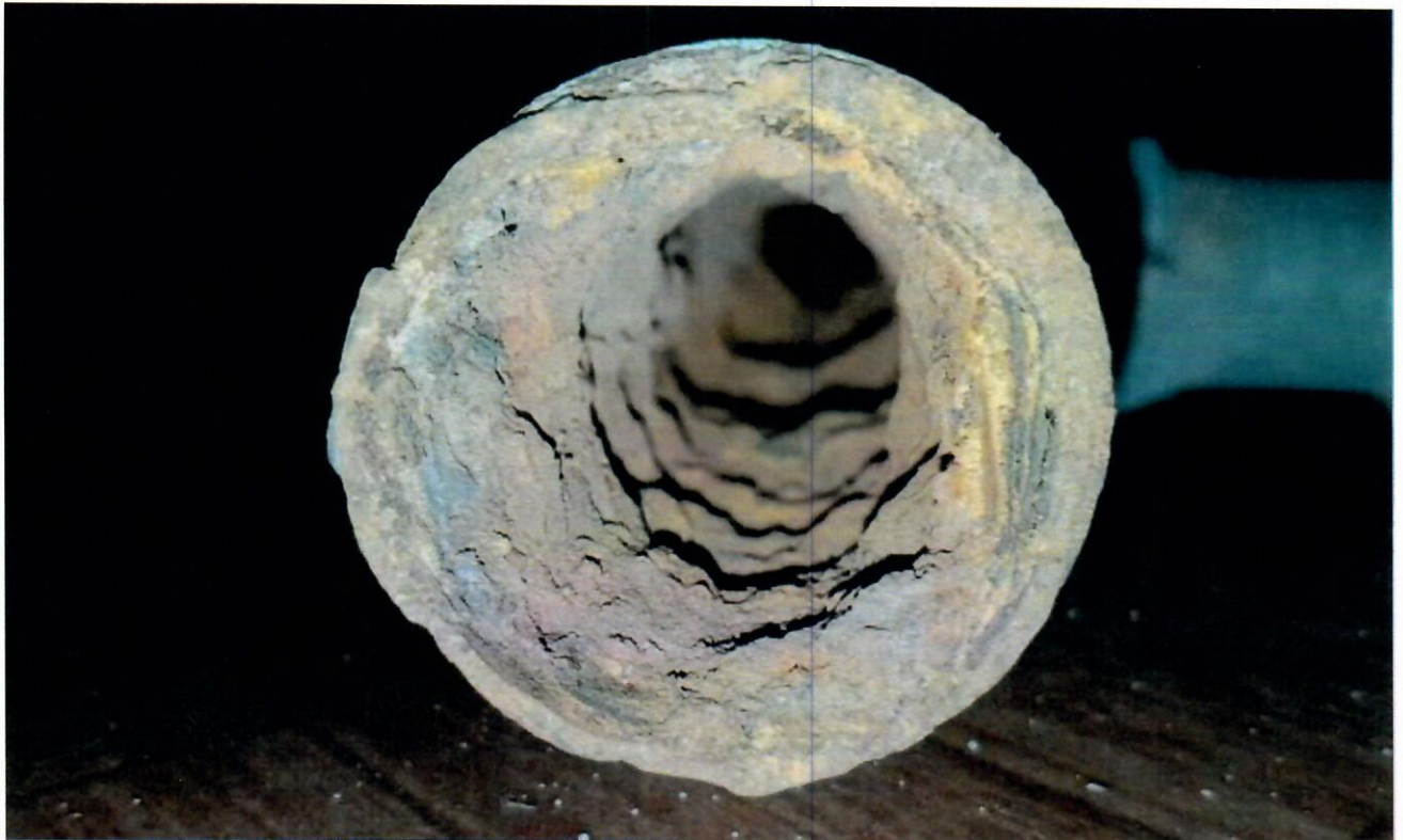
ФОТО 14 (вид торцевой поверхности в зоне разрушения трубопровода; коррозионно-наносные отложения на внутренней поверхности трубы)
