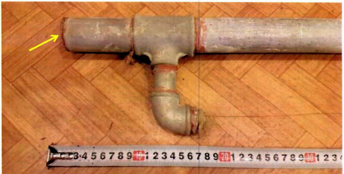
ФОТО 6 (предоставленный к исследованию участок трубопровода; месторазрушения показано стрелкой)
