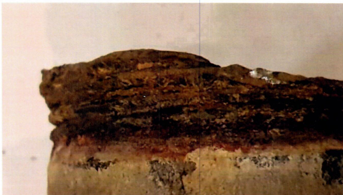
ФОТО 25 (коррозионные повреждения металла на наружной поверхности трубы в её резьбовой части)
